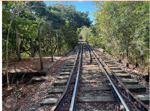
Foto 2: Vista para o tabuleiro do pontilhão ferroviário, nas imediações das ruínas da antiga estação. Edilson Borges, junho de 2024.
