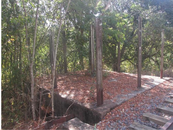
Foto 3: Vista geral para o piso e os pilares metálicos oxidados da antiga estação ferroviária. Edilson Borges, junho de 2024.
