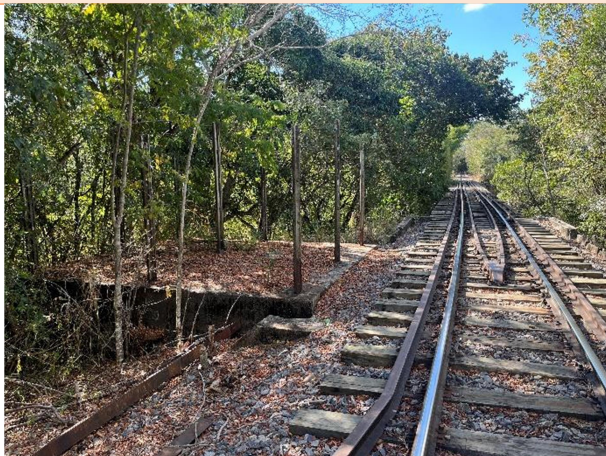
Foto 1: Ruínas da estação ferroviária do distrito de Carvalho de Almeida, onde subsistem apenas os pilares em estacas metálicas. Edilson Borges, junho de 2024.
