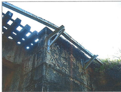
Detalhe da estrutura metálica na lateral em que não existe o duto com fiação.
