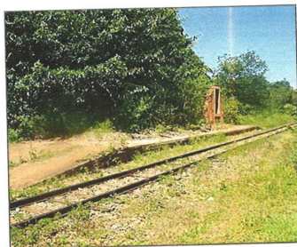
Vista lateral direita da ruína da Estação, juntamente com a antiga plataforma de embarque e desembarque e os trilhos do trem. IMAGEM: Sofia Cunha, mar/2009.
